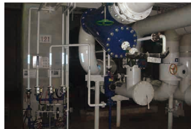
冷凍機冷凝器自動清洗節能
