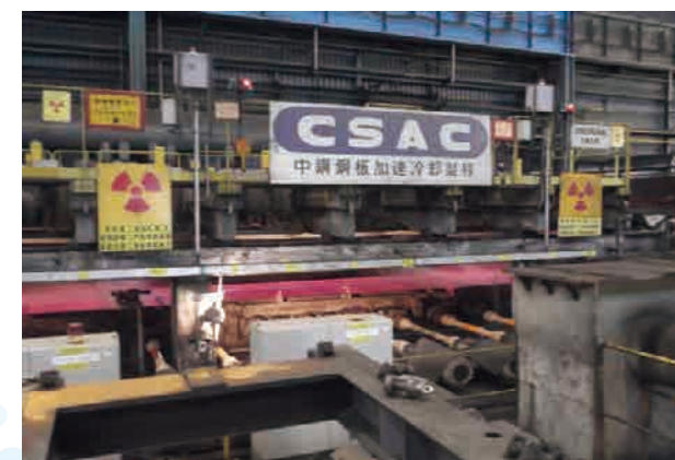
鋼板線上加速冷卻設備
