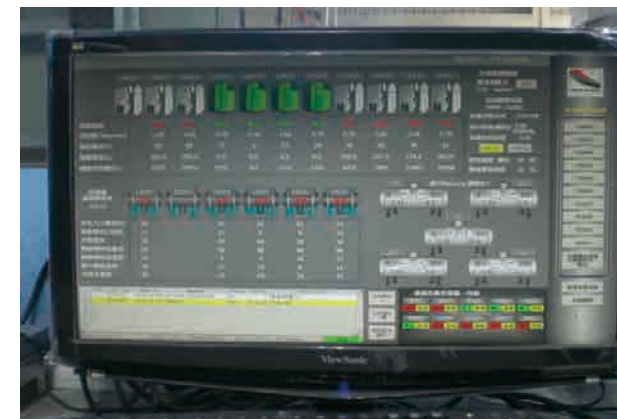
空壓機監控系統
