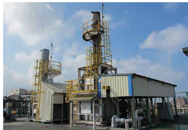
製膜廠焚化爐
