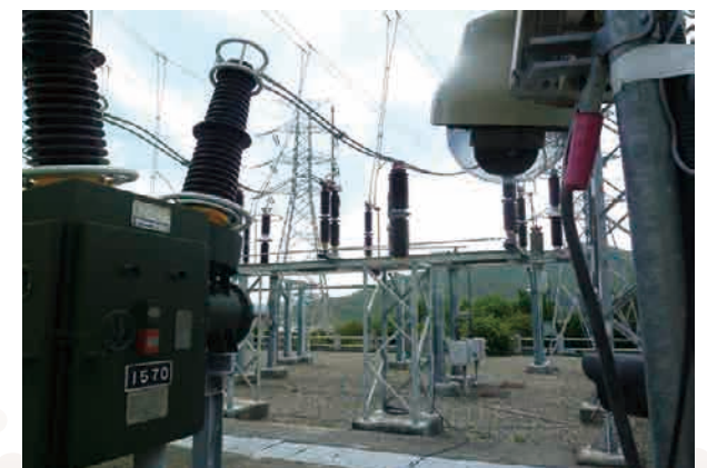
楓港變電所遠端監視操作
