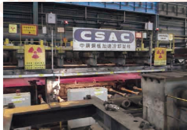
鋼板線上加速冷卻設備
