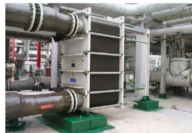
淡鹽水熱回收系統 - 熱交換器
