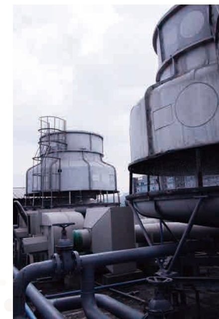
中央空調系統冷卻水塔併連照片
