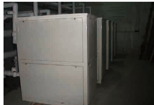
休閒會館 SPA 熱泵冷源回收系統
