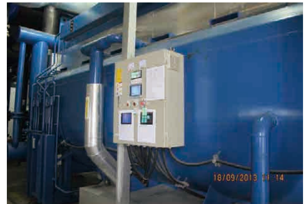
吸收式冷凍機
