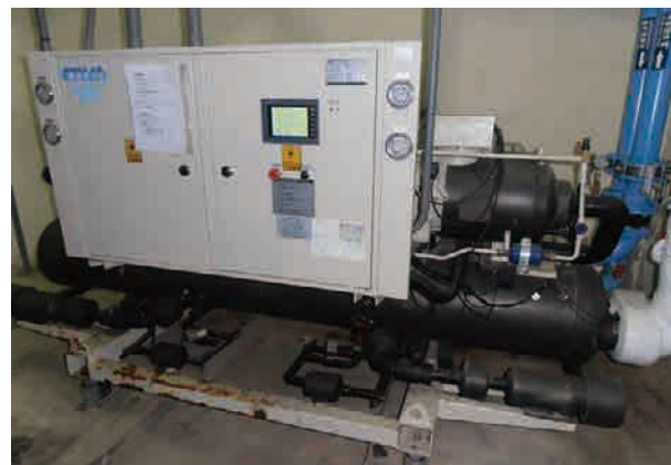
藝文中心高效率冰水主機
