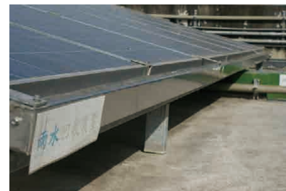
屋頂 - 太陽能設施 (含雨水回收裝置)
