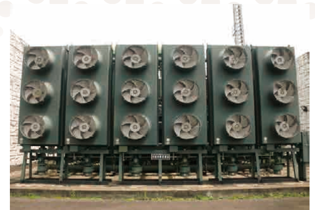
變壓器冷卻系統節能改善
