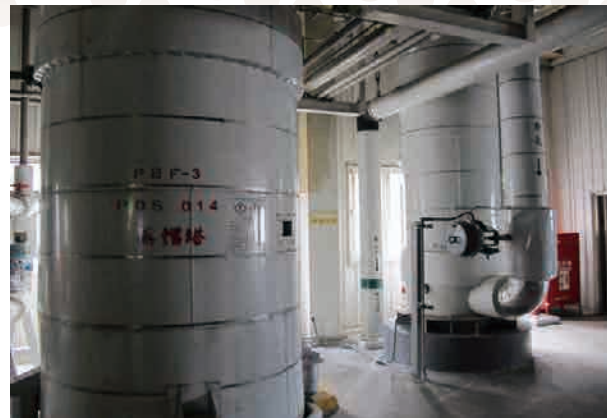
酯化蒸餾塔節能改善
