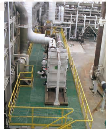
淡鹽水熱回收系統 - 操作架台
