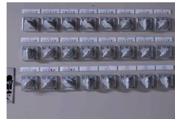
IEN 控制冰水電動閥迴路照片
