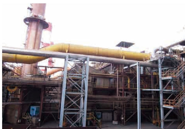
使用輔助燃料焦爐氣鍋爐
