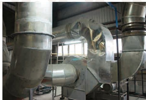
燒成窯前廢熱煙道熱回收
