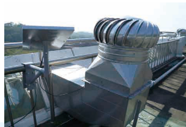
圖書資訊大樓熱浮力通風系統
