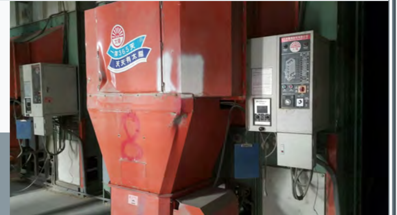
更新後燃糠爐
