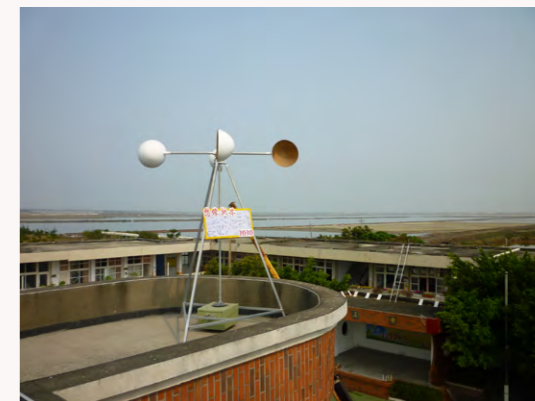
風力發電裝置
