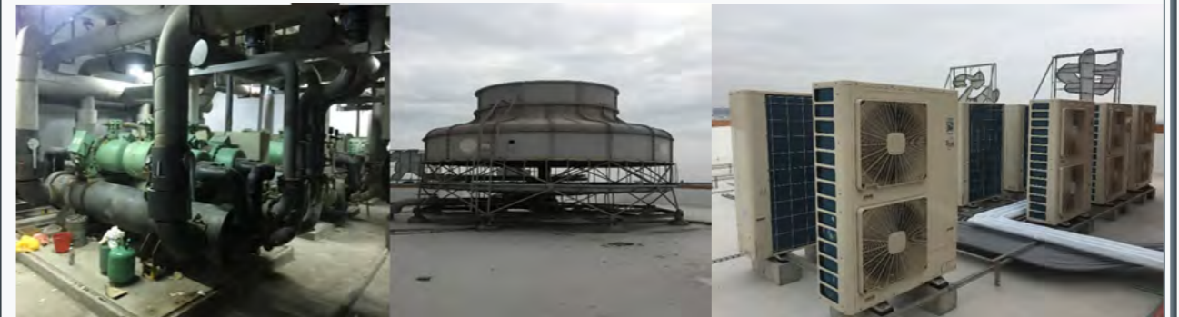
改善前：舊式冰水主機
