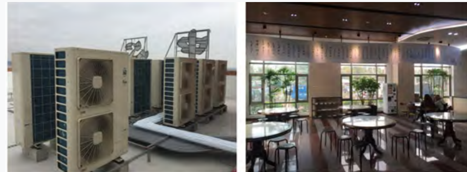
全區空調系統配合調高室內溫度
