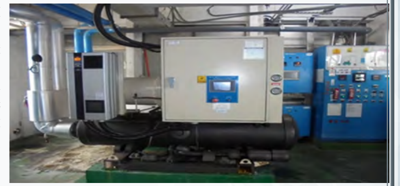
調配室冰水管路附屬設備
